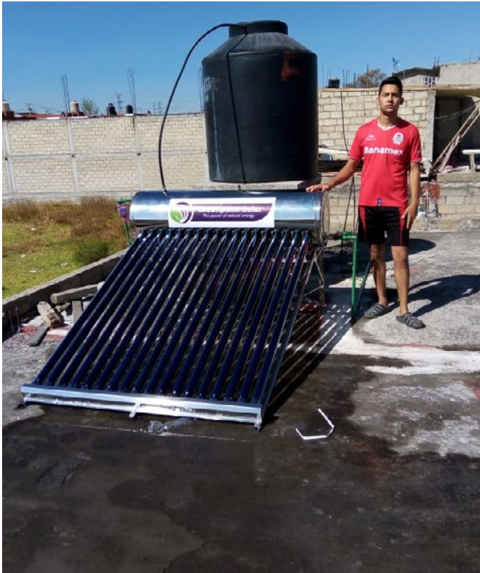
Usuario de Graviti después de la instalación de su nuevo calentador solar.
